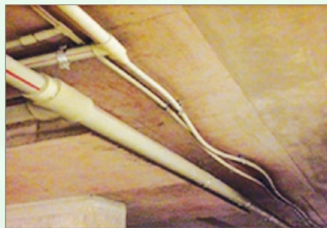
PP-RCT BETA: Presencia de curvatura en instalaciones de agua caliente.
